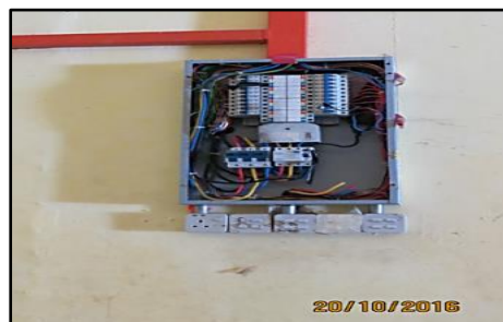
Dewan Orang Ramai Pedas, Rembau - Kotak Suis Tiada Penutup (20.10.2016)
