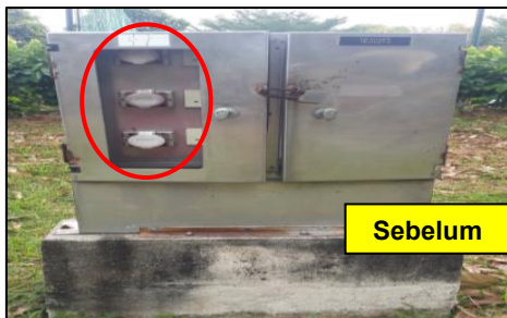
Taman Komuniti, Port Dickson - Cermin Penutup Suis Power Outlet 2 yang Telah Pecah (12.10.2016)
