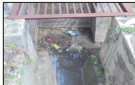
PPR Senawang Bersepadu - Longkang Tidak Disenggara (08.12.2016)
