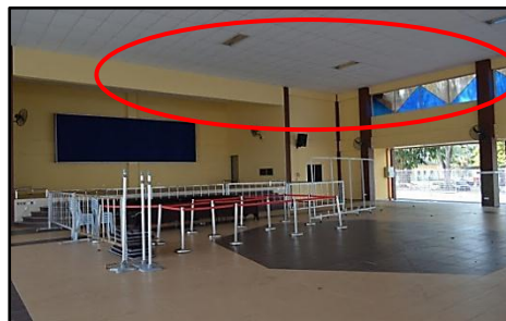
Agora, Rembau - Kipas Siling Tidak Dipasang Seperti Lukisan Kontrak (20.10.2016)
