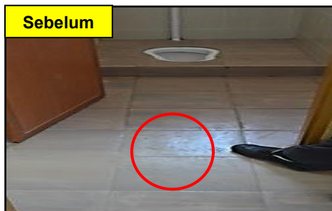
Dewan Komuniti Bandar Sunggala - Pembinaan Drop Tidak Dibuat di Kawasan Lantai Tandas (10.10.2016)
