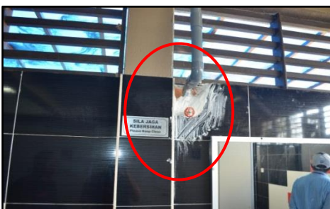
Pantai Cahaya Negeri - Keadaan Jubin yang Telah Pecah Akibat Kerja Pembaikan (10.10.2016)
