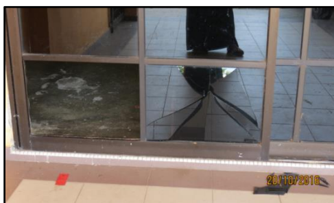
Dewan Orang Ramai Pedas, Rembau - Cermin Pintu Utama Pecah (20.10.2016)
