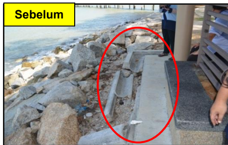
Pantai Cahaya Negeri - Longkang di Bahagian Tepi Wakaf yang Telah Pecah (10.10.2016)
