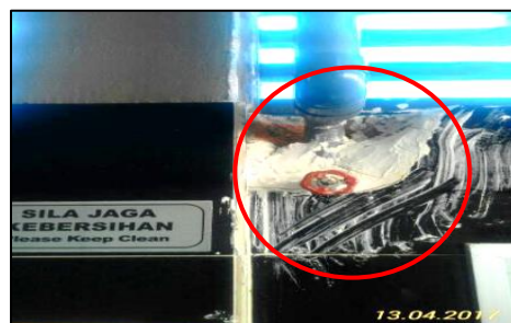
Pantai Cahaya Negeri - Keadaan Jubin yang Telah Pecah Masih Belum Dibaiki (13.04.2017)
