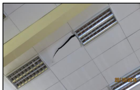
Dewan Orang Ramai Pedas, Rembau - Siling Bahagian Dalam Dewan Pecah (20.10.2016)
