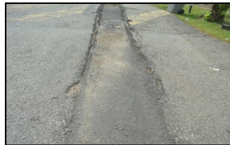
RAHR Taman Intan Duyung - Korekan Jalan Tidak Ditampal Dengan Sempurna (08.12.2016)
