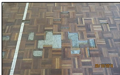
Dewan Orang Ramai Pedas, Rembau - Lantai Parkir Telah Terkopek (20.10.2016)
